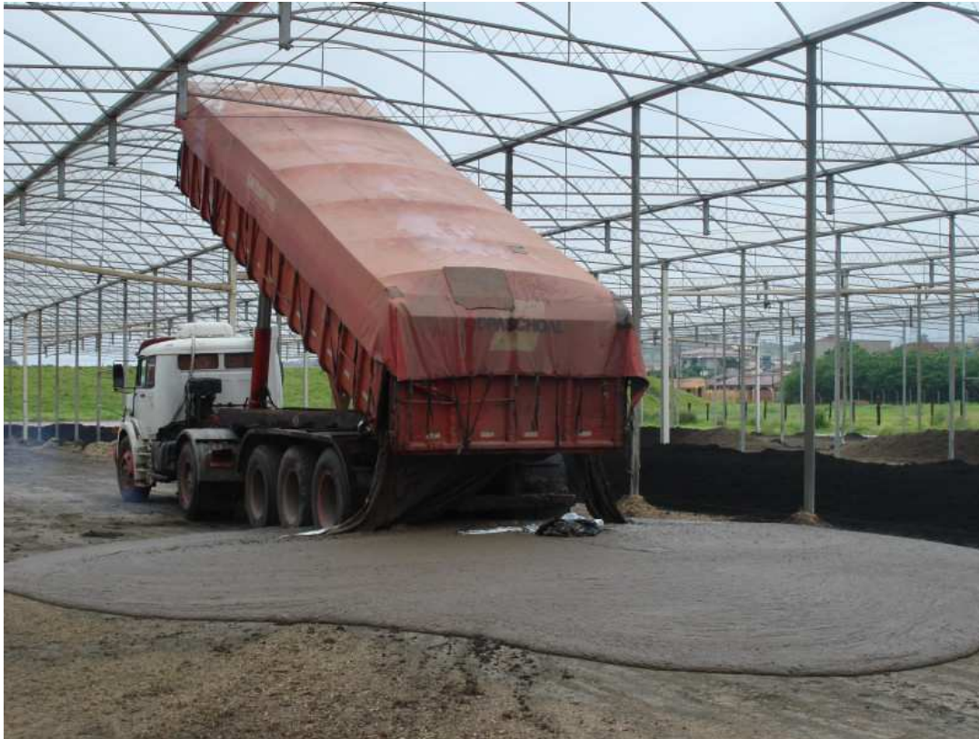
Figura 6.3: despejo de lodo com cal em pátio para tentativa de revolvimento
